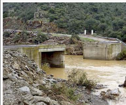
Reconstrucción. El puente sobre el río Fresneda, en Ciudad Real, será reconstruido tras derrumbarse durante las lluvias que azotaron la zona días atrás. Hasta 21 provincias están hoy en alerta por lluvia, viento o fuerte oleaje, según la Agencia Estatal de Meteorología. EFE / A. DE LA BELDAD
